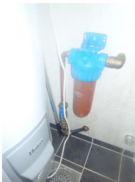
Vannfilter og hoved stoppekran
