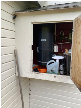
Sentralstøvsuger plassert i kasse på utsiden
