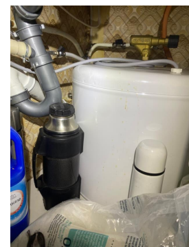
Varmtvannstank i kjøkkenbenk
