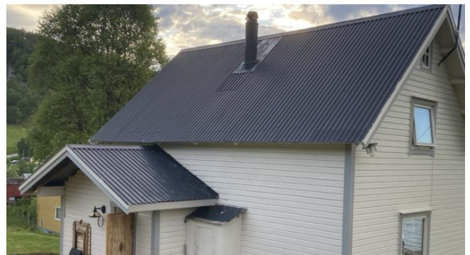
Tak har ikke takrenner, eller adkomst for feier
