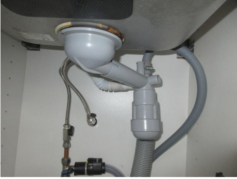
Rør i kjøkkenskap.
