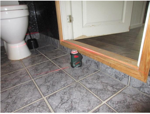
Badedør er malingslitt.
