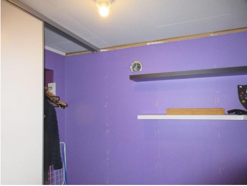
Malingslittasje på bodvegger
