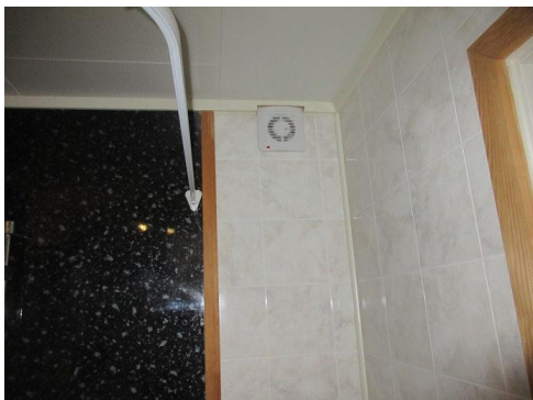
Avtrekksvifte i vegg.
