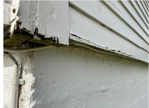
Fuktig bordkledning med sprekker i overflate
