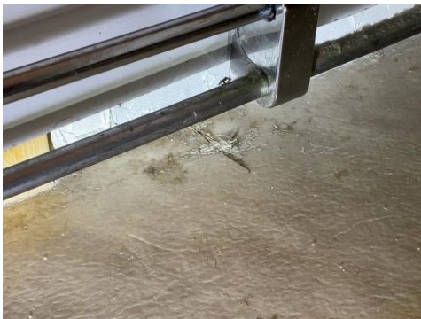
Sprekk i vinylbelegget
