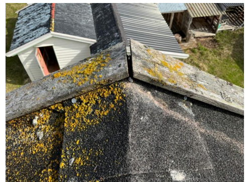
Mose på taktekke og vannbord
