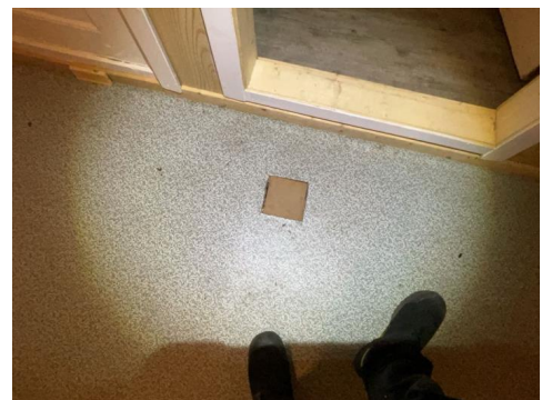
Hull i gulv i kjeller
