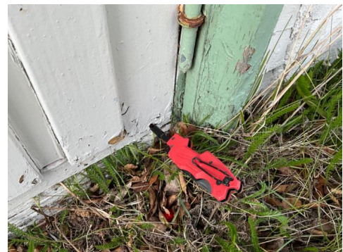
Råteskader i dør
