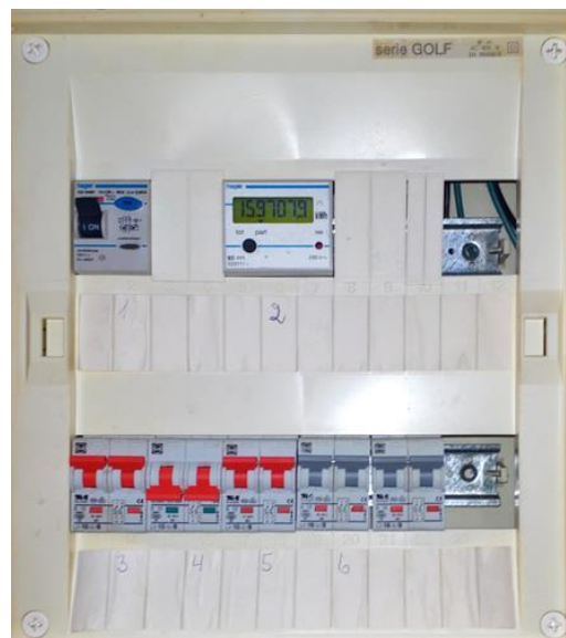
Elektrisk anlegg - [Sikringskap tilbygg]
