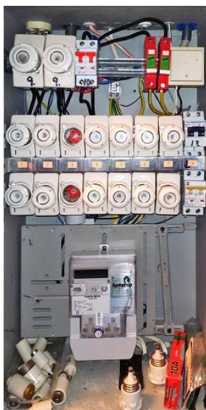
Elektrisk anlegg - [Sikringsskap hoveddel]
