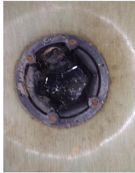
Våtrom - [Sluk tilbygg]
