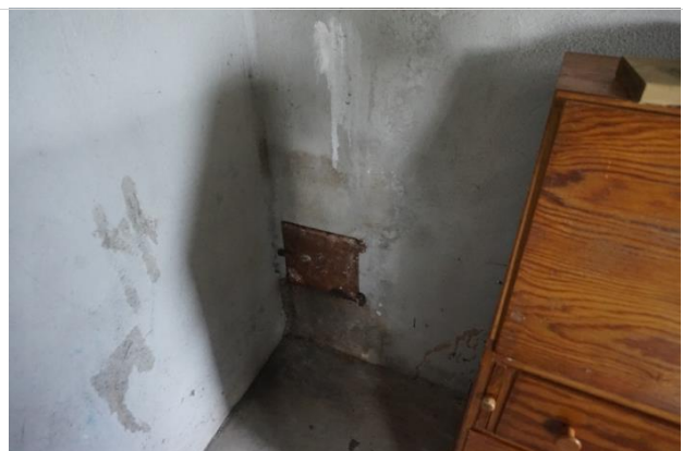
Fukt og saltutslag.
