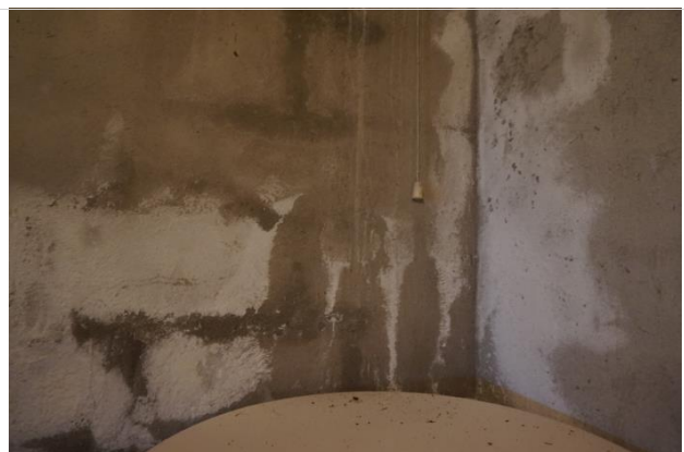
Fukt og saltutslag på vegger i kjeller.
