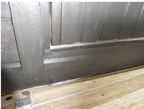
Beslag ved terskel er ikke etablert.
