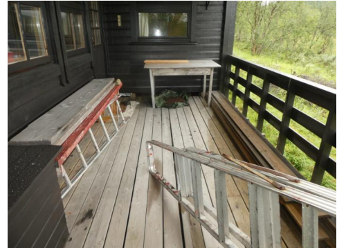
Rekkverk er under 90 cm og åpninger i rekkverk er over 10 cm. Dette bør endre.
