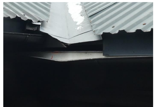
Takrenne er nedbøyd
