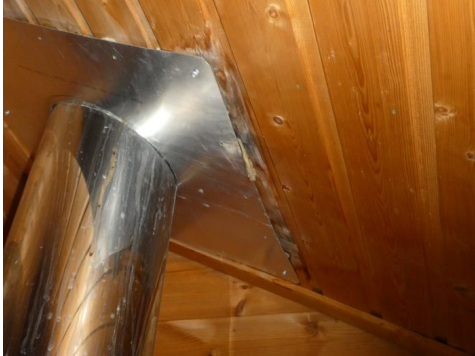
Det er fuktskjolder på panel rundt pipegjennomføring
