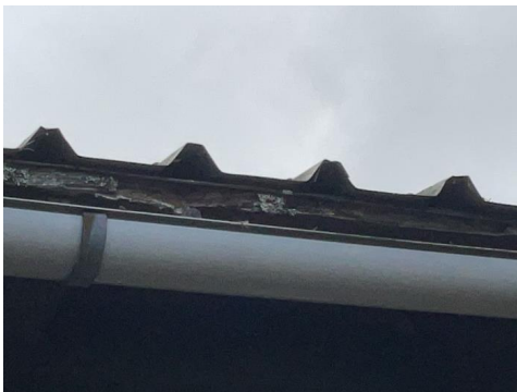
Manglende spillblekk fra tak ned i takrenne er ikke montert. Skade på trobord.
