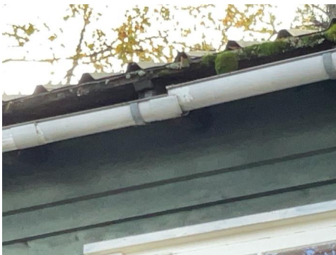
Brudd i takrenne.
