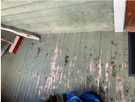
Malingsavflassing på gulv.
