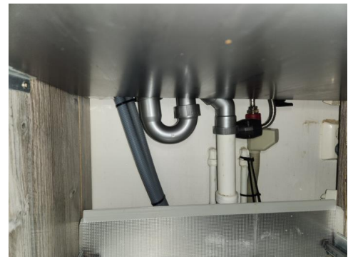
Tilkobling i kjøkkenbenk.
