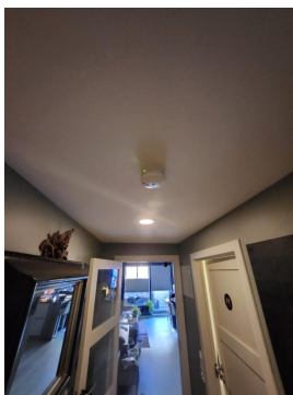
Seriekoblet brannvarsling i bygningen.
