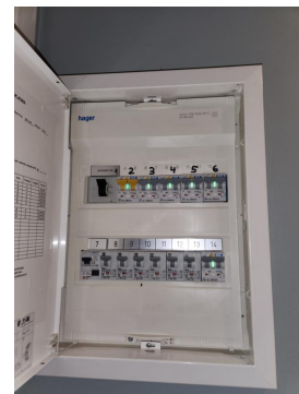
Automatsikringer i sikringskap.
