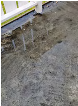
Stående vann på balkong på hovedplan
