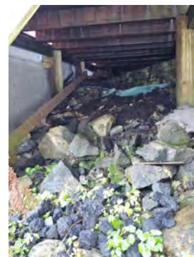
Terrenget faller inn mot murer på bygget
