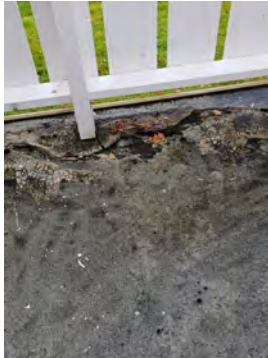
Skader i dekke på balkong hovedplan
