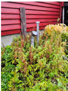
Lufting og påfyllingsrør til oljetank
