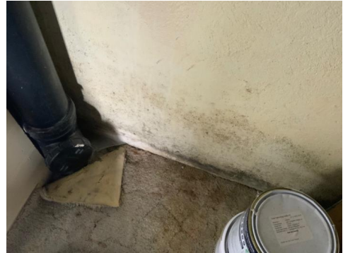
Fuktskjolder på grunnmur til gamledelen i bakkant ved trapp, tyder på dårlig drenering og utvendig fuktsikring og isolering her.
