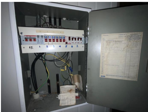
Sikringskap i 2. etg.
