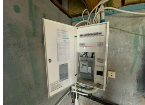
Nyere sikringskap i kjeller.
