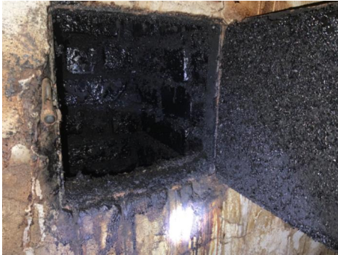
Det er en stund siden pipen er feiet og murfuger er slitte inne i pipa.
