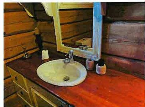
Manglende membran på vegg ved servant
