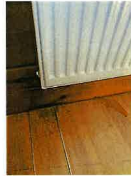
Fuktskjolder på gulv under radiator
