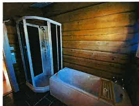
Manglende membran på vegg i dusj- og badekarsoner
