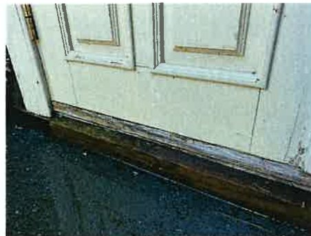
Slitt dørstokk og utside på hoveddør
