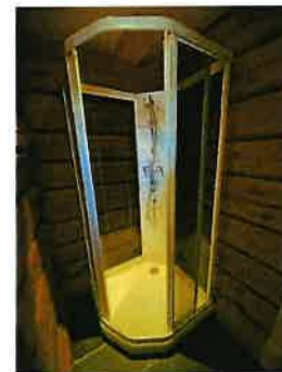
Manglende membran på vegg i dusjsone
