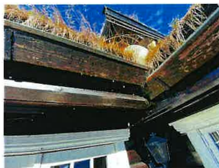
Takrenner har punktvis lekkasjer
