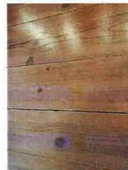
Tørkesprekker mellom gulvbord
