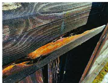
Lokal råte i rekkverk
