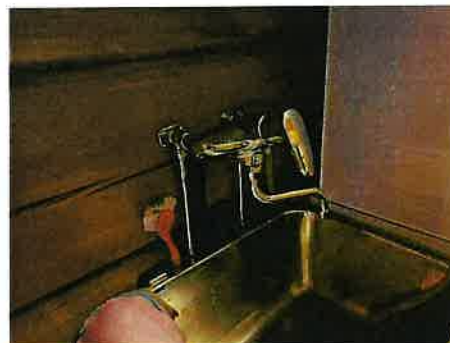
Manglende membran på vegg ved vaskeum
