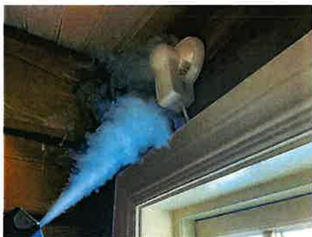
Godt avtrekk LOFTETASJE > BAD
