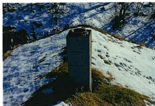
Ikke tilstrekkelig behandlet/beslått utvendig
