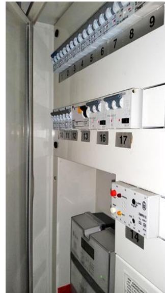
Elektrisk anlegg - [Brennbakkvegen 2 - Sikringskap 1. ETG (11.09.2023)]
