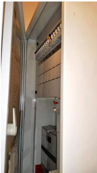
Elektrisk anlegg - [Brennbakkvegen 2 - Sikringskap U. ETG (11.09.2023)]
