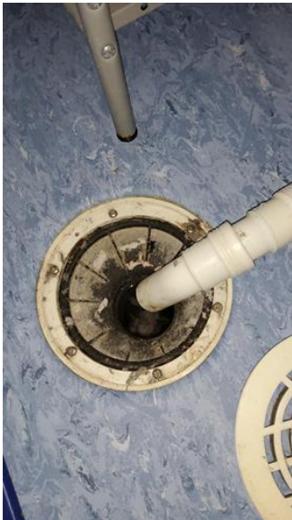
Avløpsrør (ink. sluk) - [Brennbakkvegen 2 L.ETG - Bad - Sluk (11.09.2023)]
