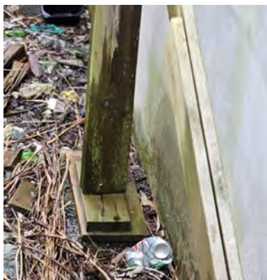
Påbegynnende råteskade på søyle
