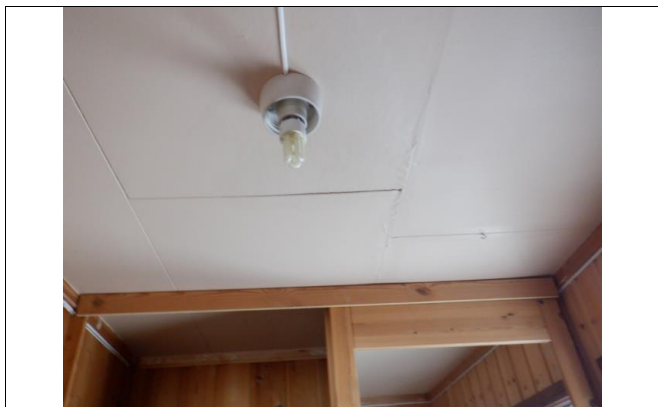
Spor av gammel vannskade i tak , vindfang.
