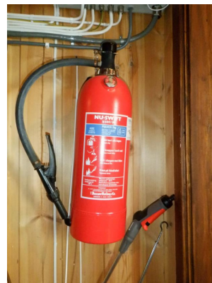
Brannslukningsapparat plassert i trappenedgang til kjeller.
