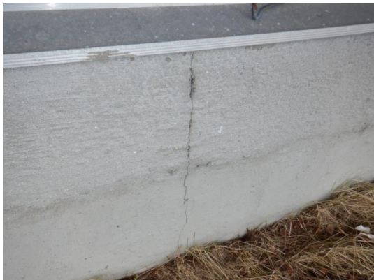
Sprekk i grunnmur
