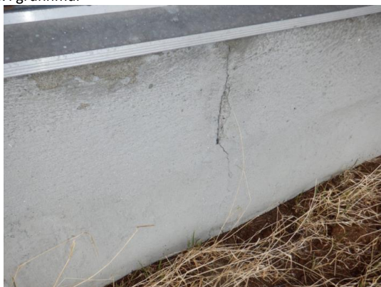
Sprekk i grunnmur
