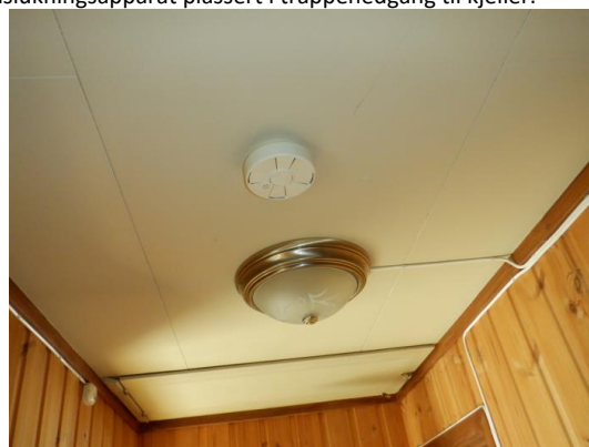
Røykmelder i tak.
