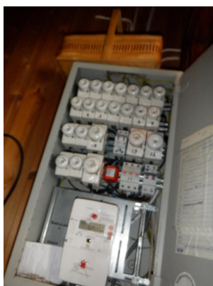
Sikringsskap plassert i nedgang til kjeller.
