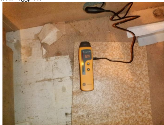
Hull i vegg, 14,6 vektprosent fukt.
