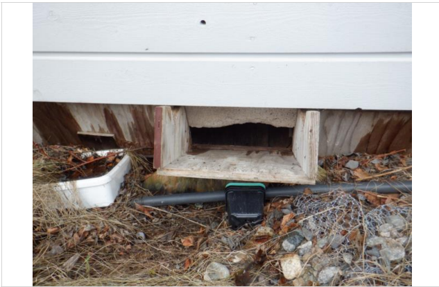
Ringmur som må utbedres.
