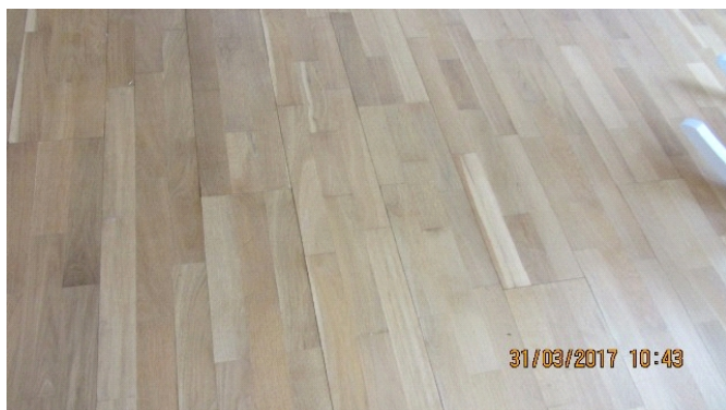
Skadet golv i stue
