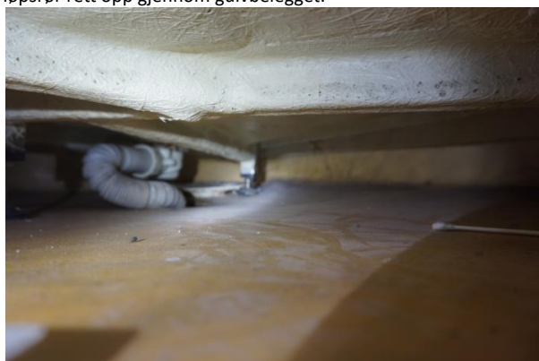
Sluk under dusjkabinett
