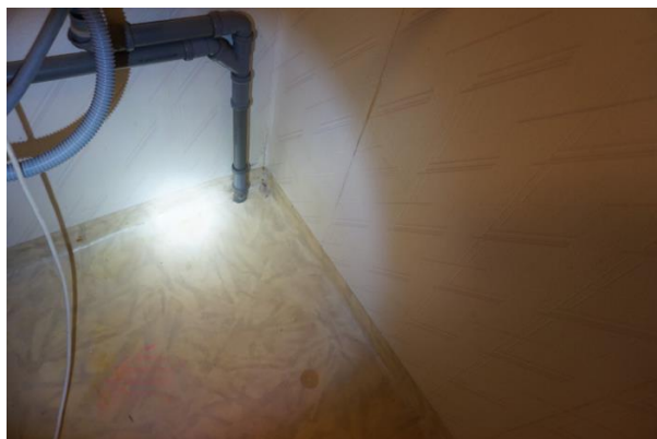
Avløpsrør rett opp gjennom gulvbelegget.
