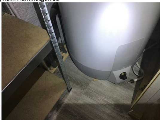
Ikke montert laminatgulv ved bereder
