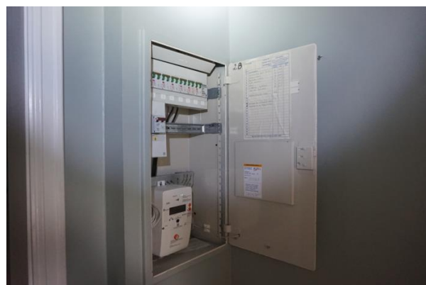
Sikringsskap med automatsikringer
