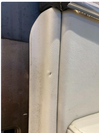
2.1 Skadet/merker etter utstyr
