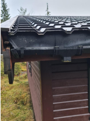
Nedløpsrør og endelukk mangler
