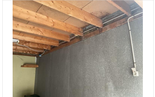
Lekkasje i garasje fra altan
