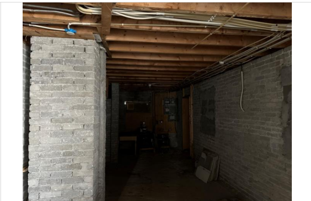
Kjeller, uisolert bjelkelag, sikringskap
