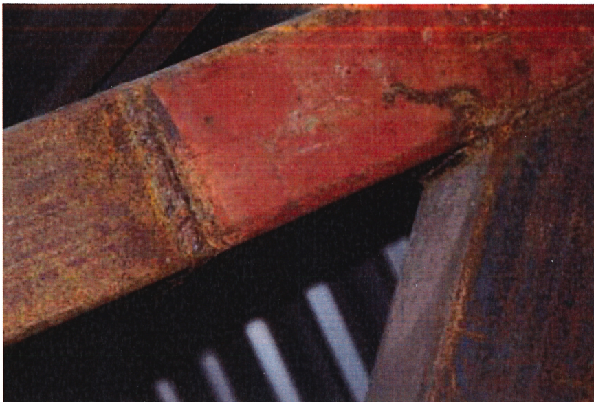
Akse 2/A: Overgurt skjøtet før diagonal til undergurt, manglende overflatebehandling.
