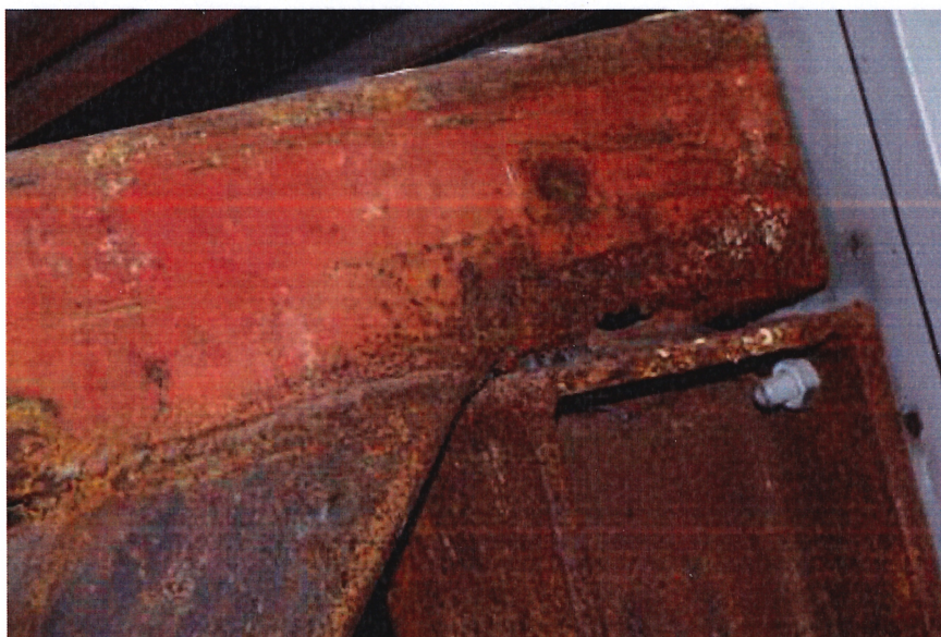
Akse 2/A: Dårlig sveis over søyle og hull i røret og antydning til sprekk i godset.
