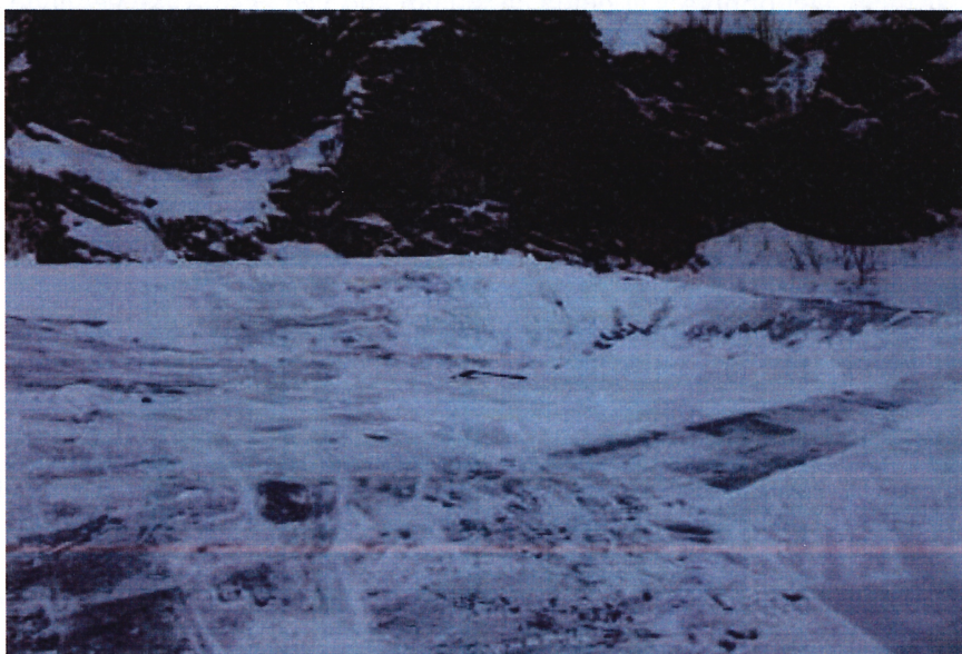
Yttertaket med dump i taket som er brutt sammen
