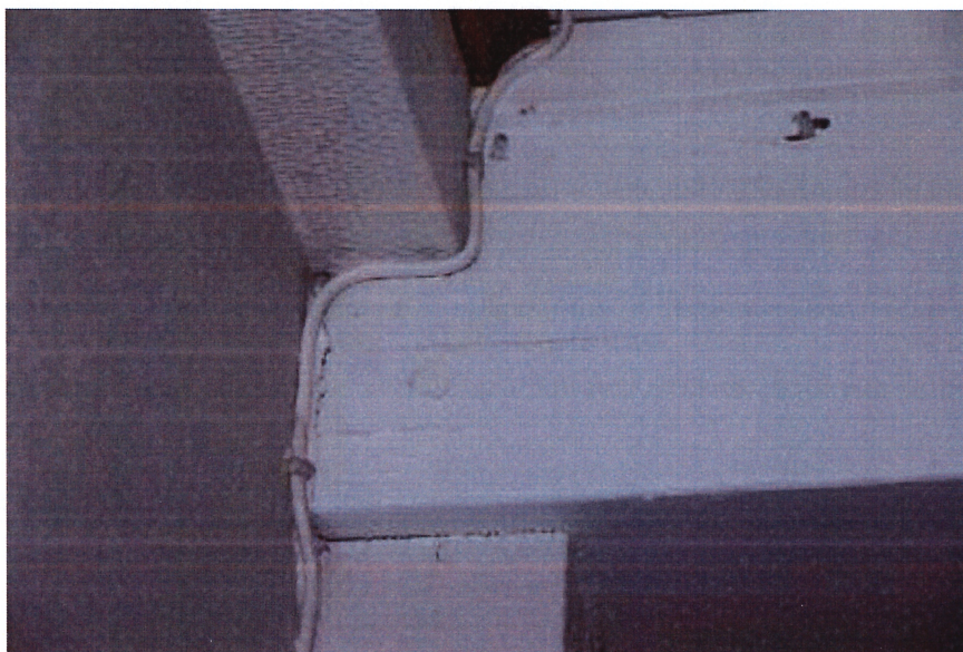
Vertikal sprekk og synlige horisontale lameller over opplegg for limtre drager mot akse 3, rotasjon over opplegg.
