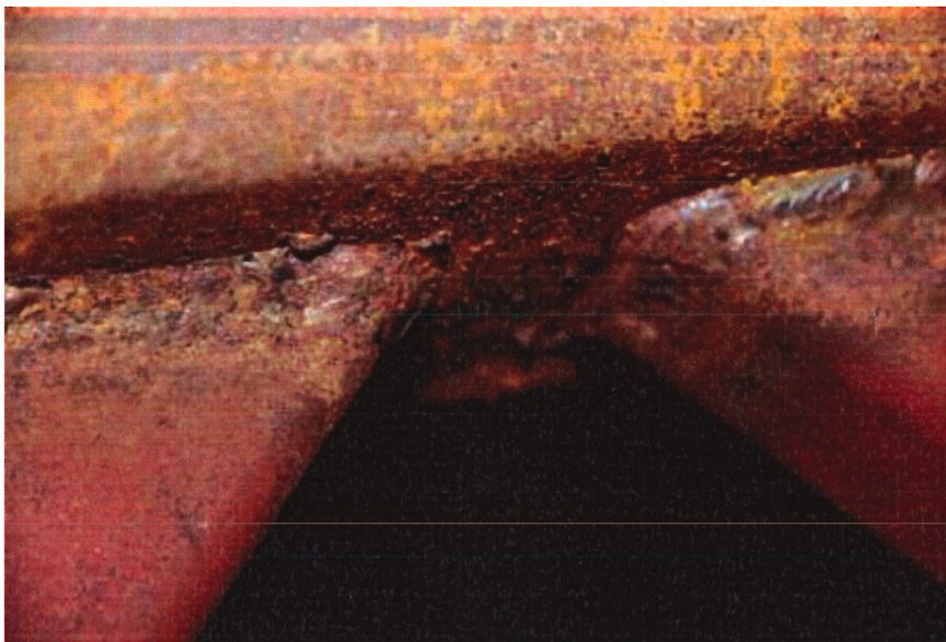
Akse 2 mellom akse A og B: Mye rust i overgurt og sveiseskjøt for diagonaler. Mangelfull sveis.
