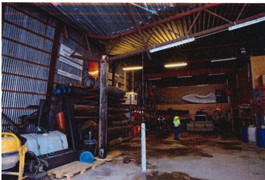
Skaden akse 1 – akse 4.
