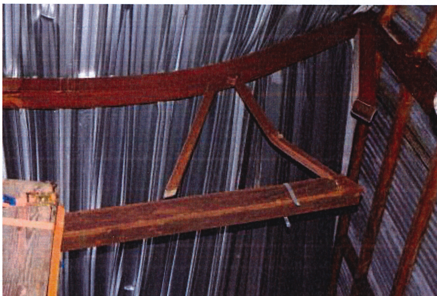
Akse 2: Diagonal fra opplegg søyle for undergurt er slitt tvers av i sveiseskjøt.
