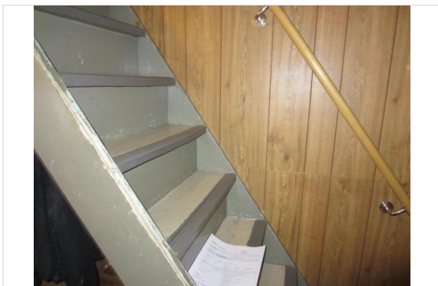
Ikkje rekkverk på trapp. Redusert høgde ved trapp.
