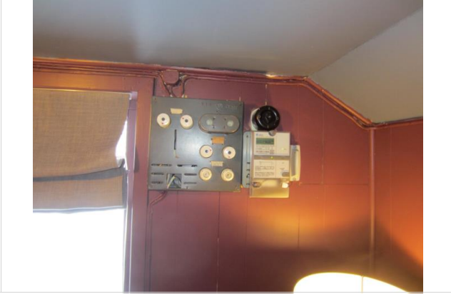
El. tavle. Under dimensjonert i høve dagens utføring.
