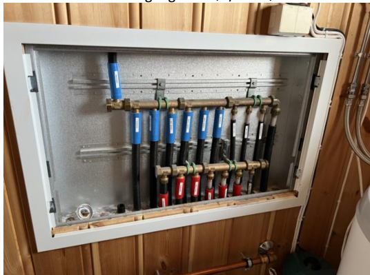
Fordelerskap plassert på bad/teknisk rom, mangler frontdeksel mellom dør og skap
