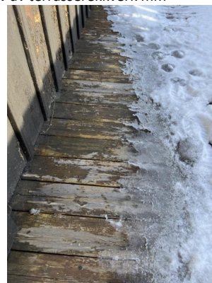
Vedlikeholdsbehov av terrassegulv
