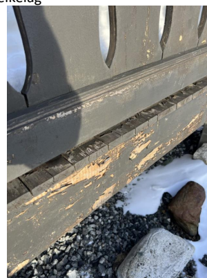
Vedlikeholdsbehov av terrasserekverk mm
