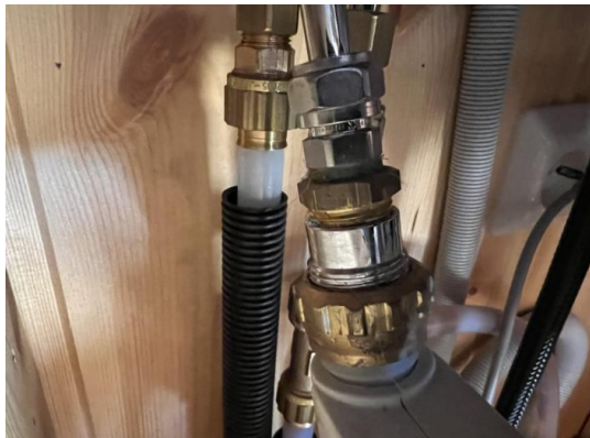
Manglende tettemuffe i overgang vannrør/varerør
