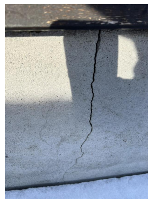
Sprekk i mur på opprinnelig del
