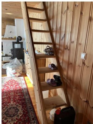
Manglende håndløper på trapp
