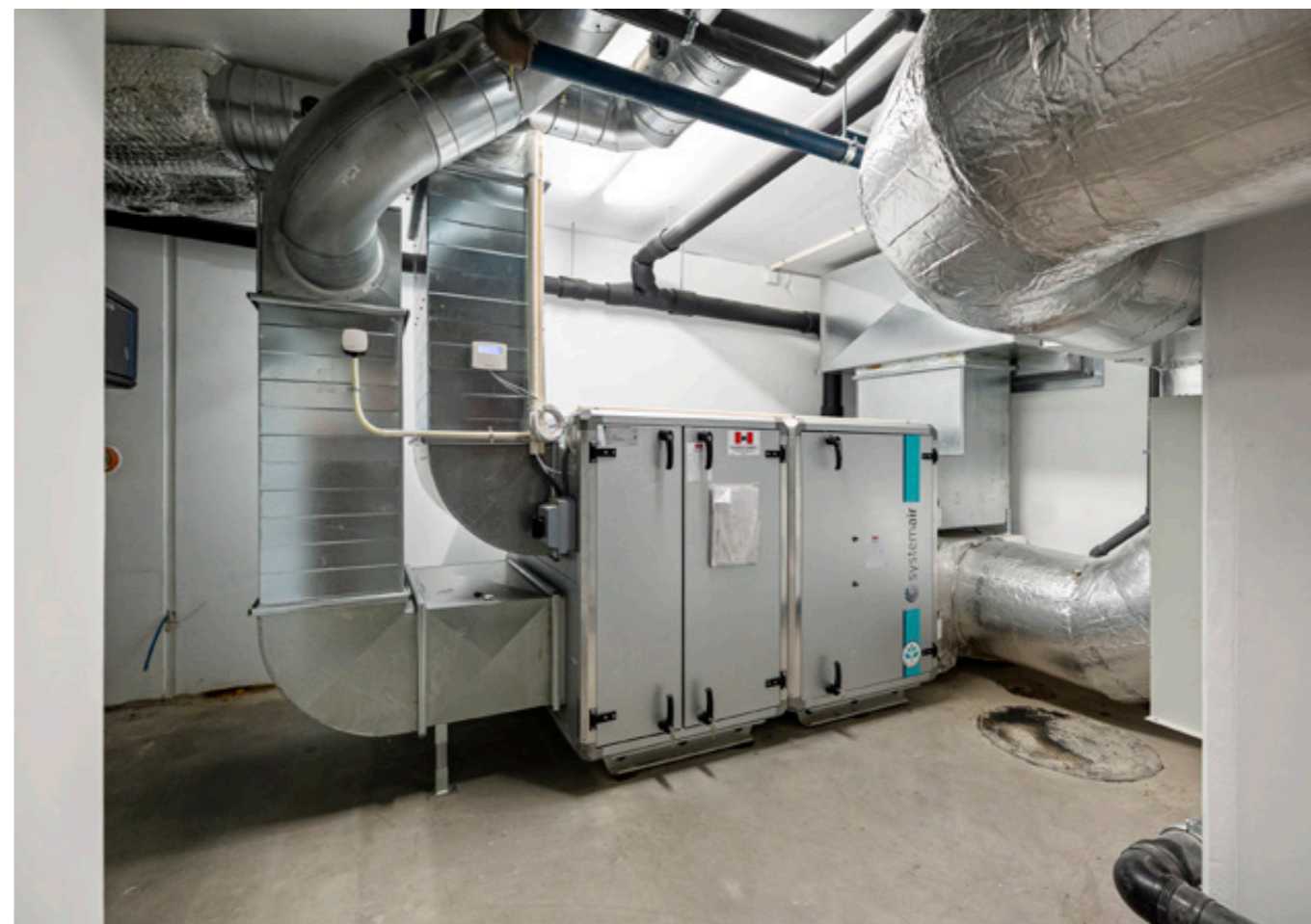
Teknisk rom i kjelleretasje.
