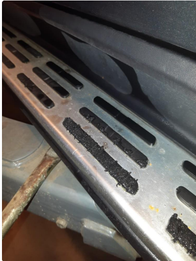
1.1 Litt slitasje på stigtrinn
