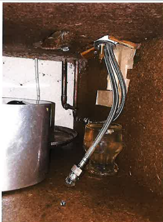
Kobling på kaldtvann kobberrør har hoppet av.
