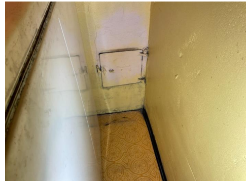
Sotluke i lagerrom uten ildfast plate på belegget.
