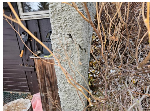
Sprekk sett forfra.
