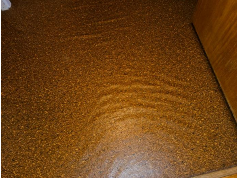
Bulker på belegget i kjellergangen.
