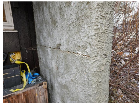
Sprekk i murvange under veranda.
