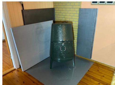
Jøtul 4 for nær veggen uten godkjent brannmursplate.
