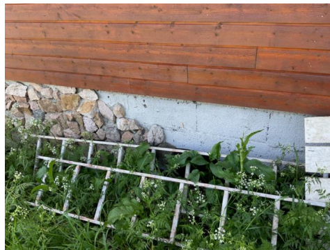
Upusset grunnmur ved inngang.
