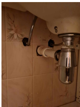
Åpne hull i vegg under servant
