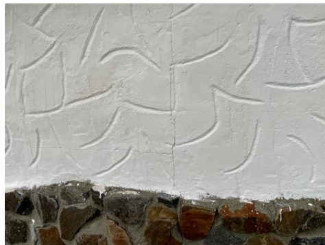
Sprekddannelse i mur .
