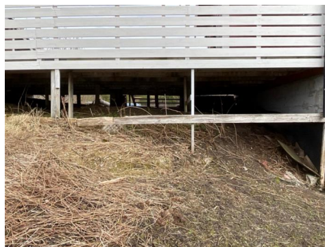
Terreng ved inngangsparti og under terrasse har fall mot bygget.
