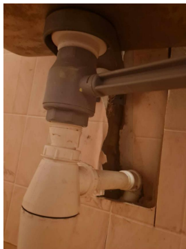
Åpent stort hull i vegg under skyllekar
