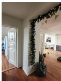
Noe helningsavvik på gulvene
