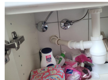
Skjulte vannledninger, plastavløp
