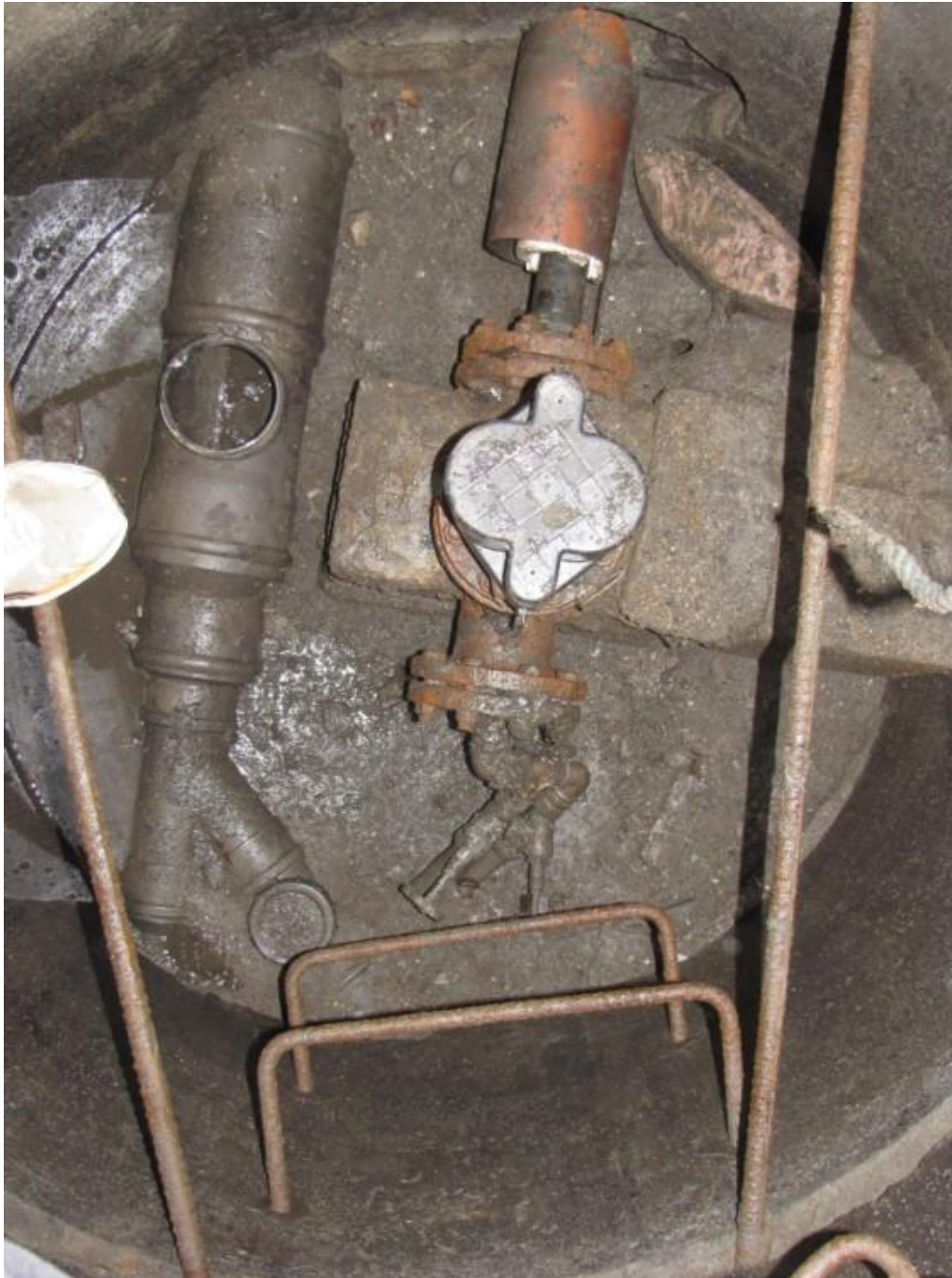
Figur 5: Eksisterende felleslum VK69 i Tøllmøvegen. Lum må erstattes.
