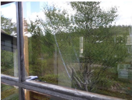
Sprekk i glass.
