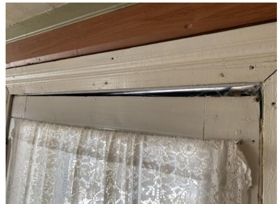
Skjevheter i dør/karm som følge av setninger i bygning
