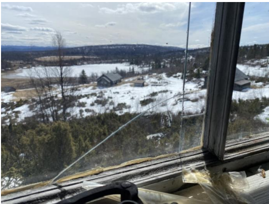
Sprekk i vindu
