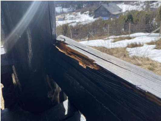
Råte i konstruksjon
