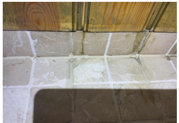
Fuger sprekker bak dusjkabinett
