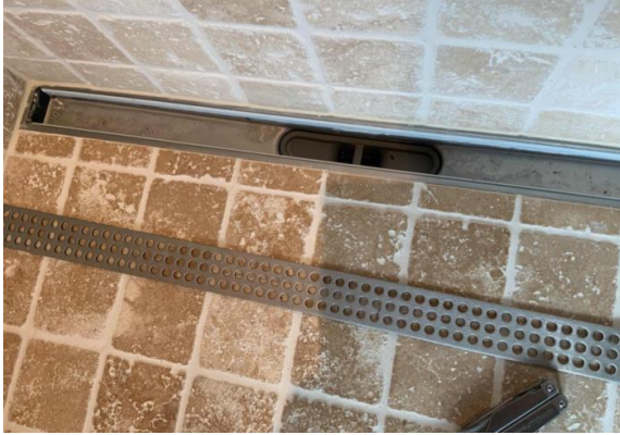
sluk i dusj 2 etasje
