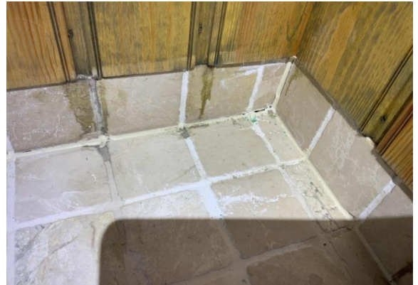
fuger sprekker bak dusjkabinett
