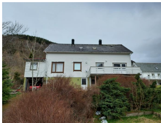
Fasade mot øst. Viser midlertidig tetting etter avblåst taktekke på Nyheim 1
