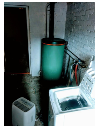
Nyheim 2: Vaskerom med varmtvannstank
