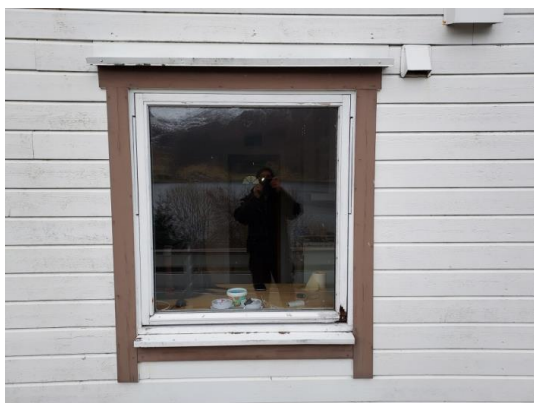
Foto avkjøkkenvindu på Nyheim 1. Råteskade på vindusramme.
