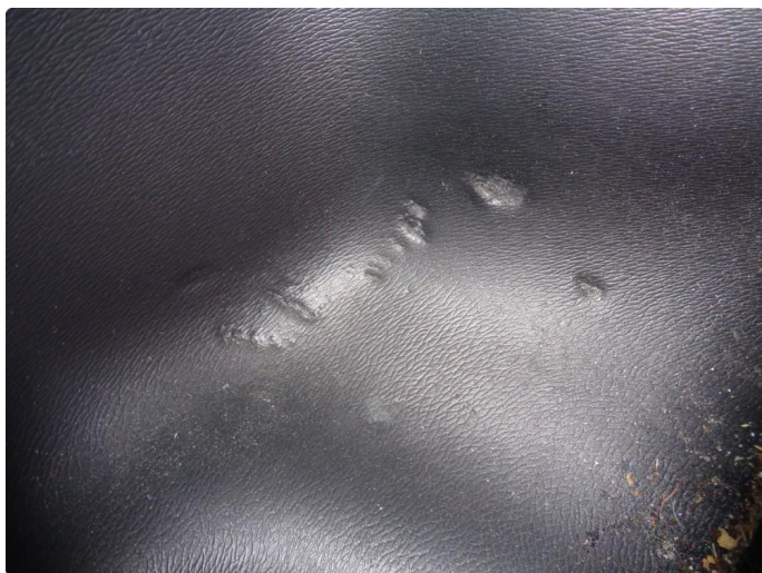
2.1 Skadet/merker etter utstyr
