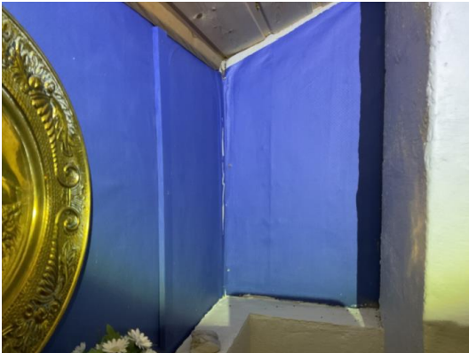
Skrukket tapet på vegg på kjøkken.
