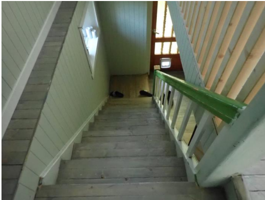
Inngangstrapp lavt rekkverk. 21 cm avstand på spilene, ikke håndlist
