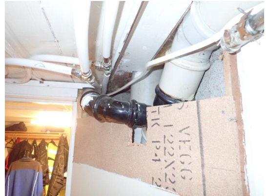
Rørøpplagg på vaskerom
