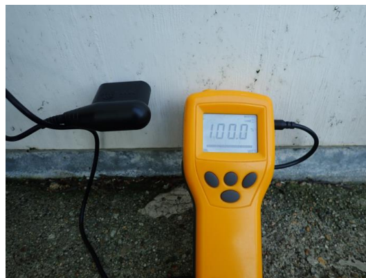
100 % fuktighet i altandøra - må skiftes.
