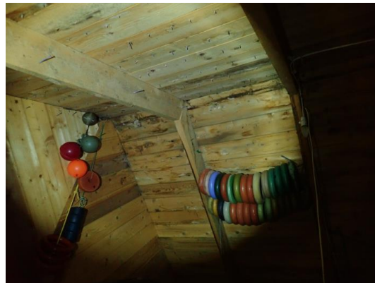
Fuktmerker i trobordene
