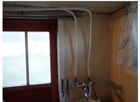
Rørøpplagg på vaskerom
