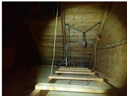
Fuktmerker i trobordene
