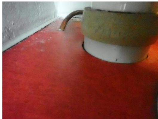
Vannrør og avløp fra wc gjennom gulv.
