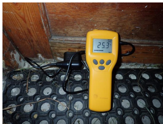
25 % fuktighet i døra fra vaskerom. Råteskader i dørstokk, rustet hengsler, trekkfull etc. - må skiftes.
