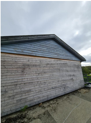
Nyere kledning som ikke er behandlet
