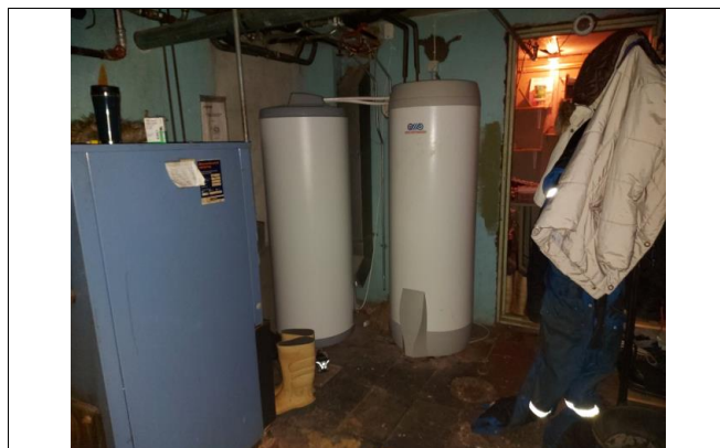
Varmtvannsberedere 2.stk på 300 l av nyere årgang i fyrrom kjeller
