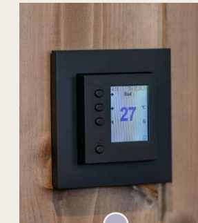
Oppgradering av el-anlegg Oppgradering av elanlegg med fargevalg sort eller hvit
