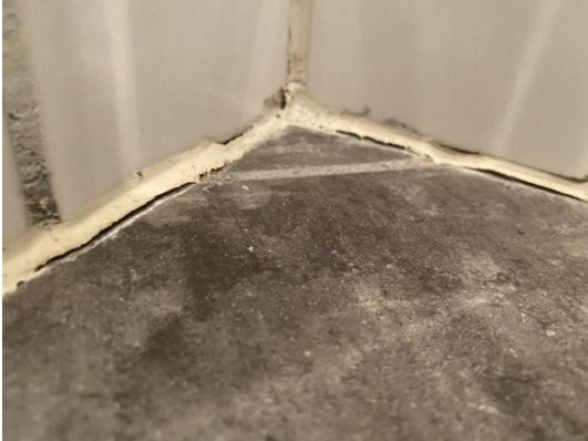
Må påregnes utskifting av mykfuge
