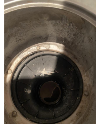
Ufagmessig membranløsning i sluk
