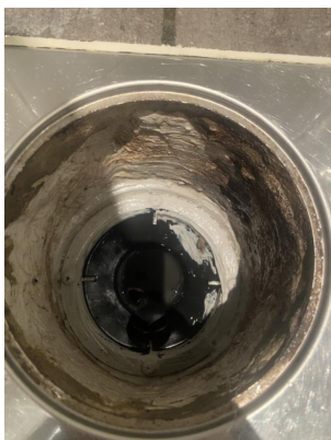
Ufagmessig membranløsning i sluk
