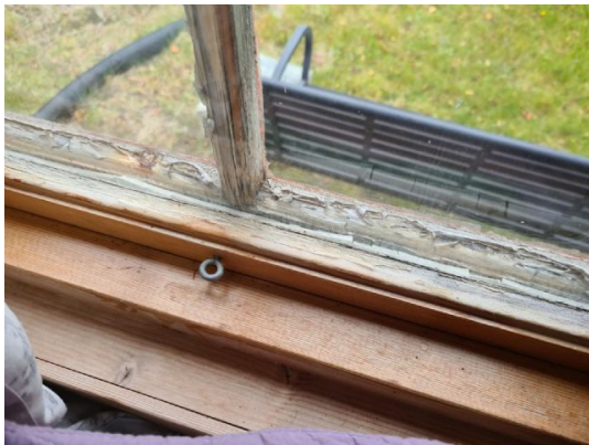
Koblede vinduer. Synlige fuktmerker/skader i vinduskarm.
