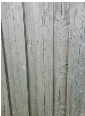
Kledning mot syd. Noe soltørket/oppsprekket kledning.
