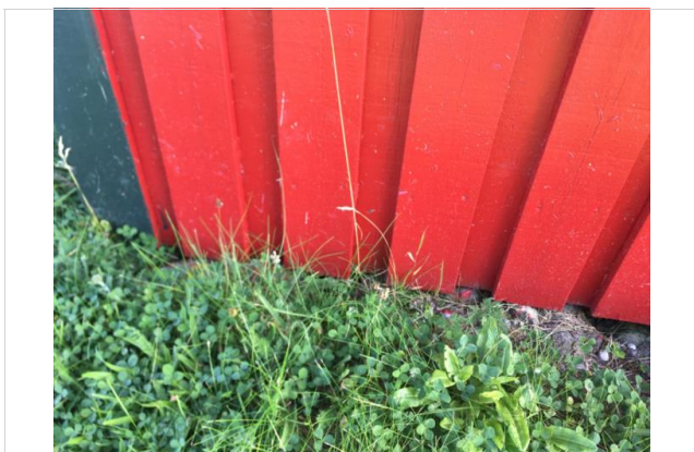
Kledning utsatt for fukt i endevend.
