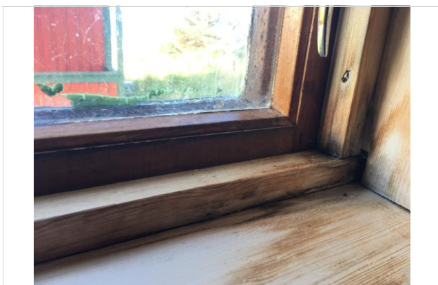
Fukt fra utett vindu
