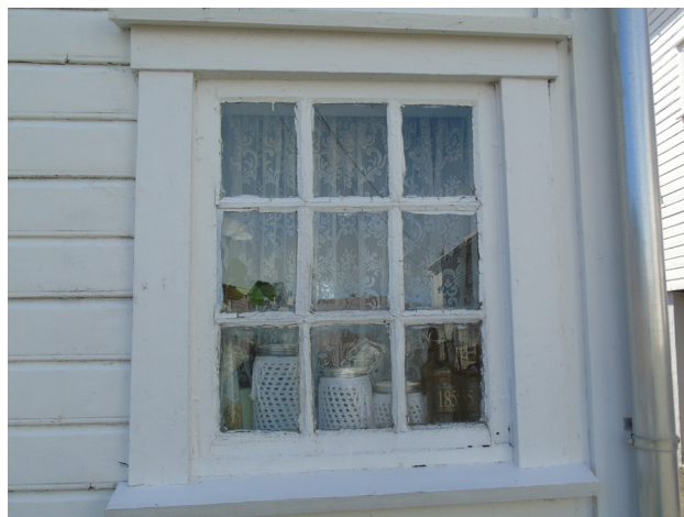
Bildet øverst: Ulike beslag på samme vindu. Bilde under: Fast vindu, kan ikke åpnes. Foto: Solveig Roti Dahl, RFK.
