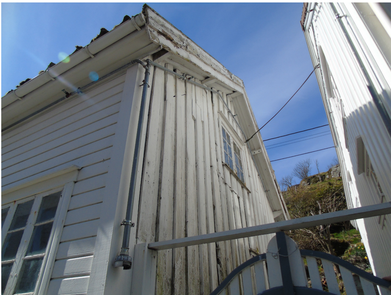
Eksempel på lappverksvegg som viser endringer og bruk av ulikt panel. Foto: Solveig Roti Dahl, RFK.
