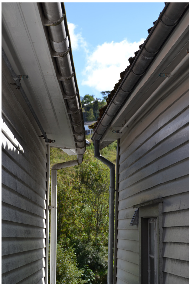
Eksempler på taknedløp, den i grå/sink har skarpe bend og kne. Foto: L. Riese
