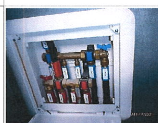
1. etg. Bad Fordelerskap vvs for rør i rør opplegg
