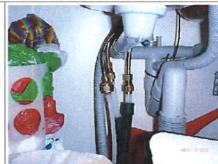
Kjøkkeninnredning, vvs tilknytning
