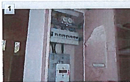
1 El. skap 1-fase strøm. El-skap med skusikringer og automatsikringer
