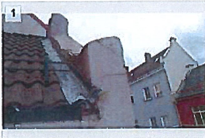
1 Ark Skader på murverk på ark mot gate
