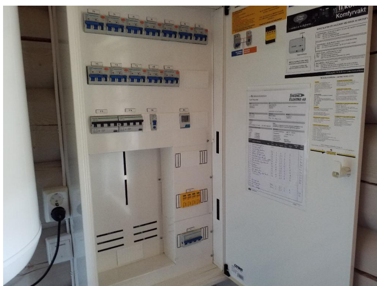
Elektrisk anlegg - [Sikringskap.]
