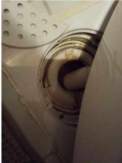
Avløp (ink. sluk) og vannrør - [Sluk på lite bad.]
