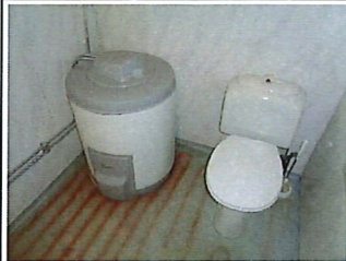
V.v. bereder på bad i 1. etasje.
