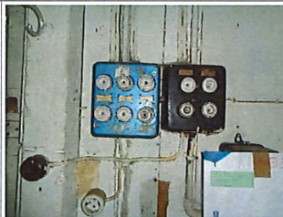
Åpent El.anlegg i underetasje.
