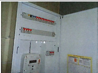
Sikringsskap i felles trappegang.
