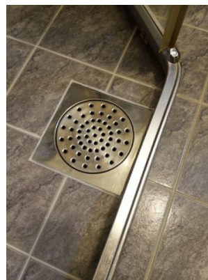
Bad i kjeller. Silikon rundt sluk
