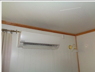
Varmepumpe i stue.
